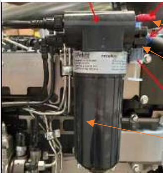
Bomba alimentadora elétrica
